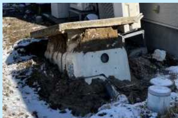
地震により浮き上がった浄化槽
