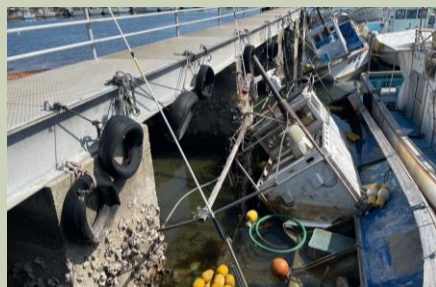
漁港施設の損壊
