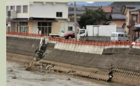
河川護岸の損壊
