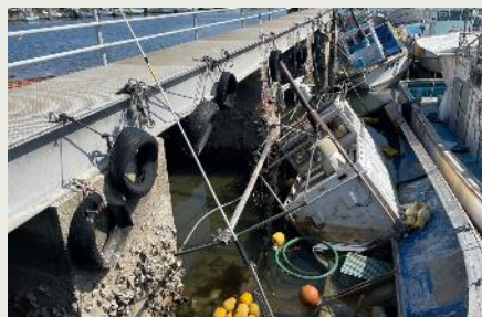
漁港施設の損壊
