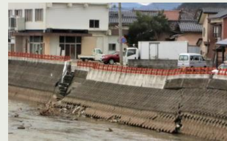
河川護岸の損壊
